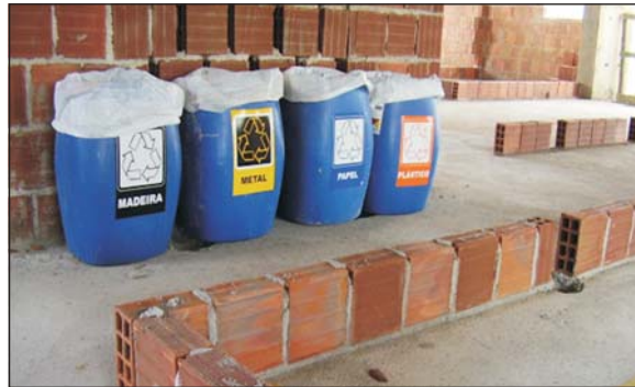
Figura 10: Exemplo de equipamentos simples de acondicionamento segregado de resíduos classe B, dispostos nos próximos aos pontos de geração.
