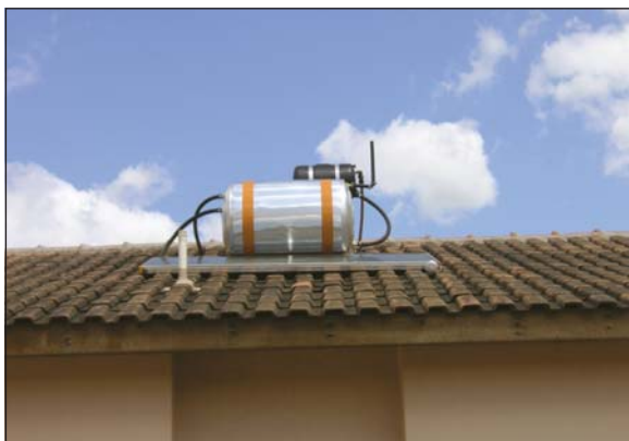
a) Simples, sobre o telhado
