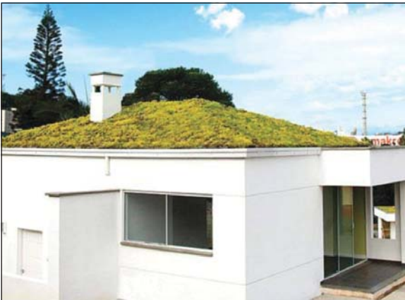
Figura 11: Teto jardim na cobertura de salão de festas de condomínio. Projeto Terra Domus, da Sphera Quattro, Florianópolis Foto (cedida pelo autor).
